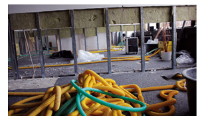
Schimmel adé: Das Problem ist beseitigt.
