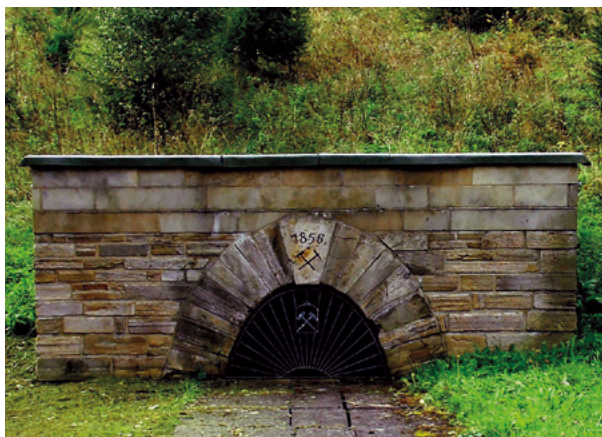
Es wird gefährlich: Wenn Sicherungen alter Schächte nicht mehr ausreichen.
