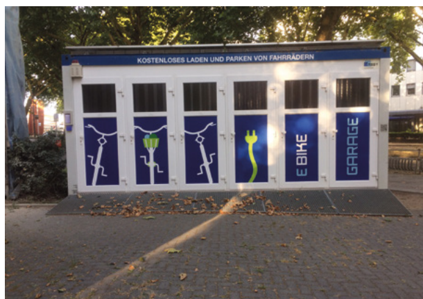
Prototyp des Stellplatzes: Die Garagen für E-Bikes mit Ladefunktion wurden an der Technischen Berufsschule am Ostring aufgebaut.
